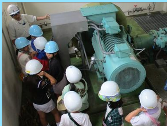
小水力発電施設の説明
